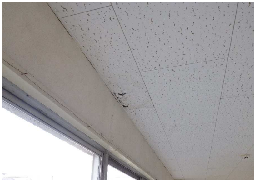
天井劣化状況
