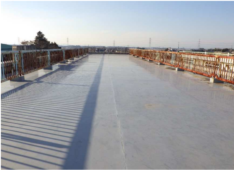
屋上防水劣化状況
